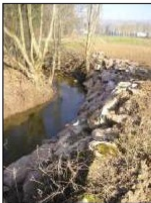
Travaux d'enrochement réalisés sans déclaration
